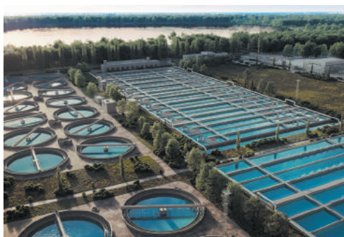
Станція для очищення стічних вод
